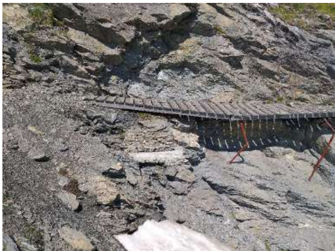
La passerella danneggiata sul sentiero degli Alpini, da sostituire con la realizzazione di una cengia scavata in roccia.- Foto M. Casale
