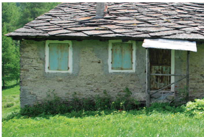
Dettaglio delle aperture metalliche non originali presenti sul fronte Ovest. Sulla destra basamento e scale in c.a. e tettoia in lamiera.
