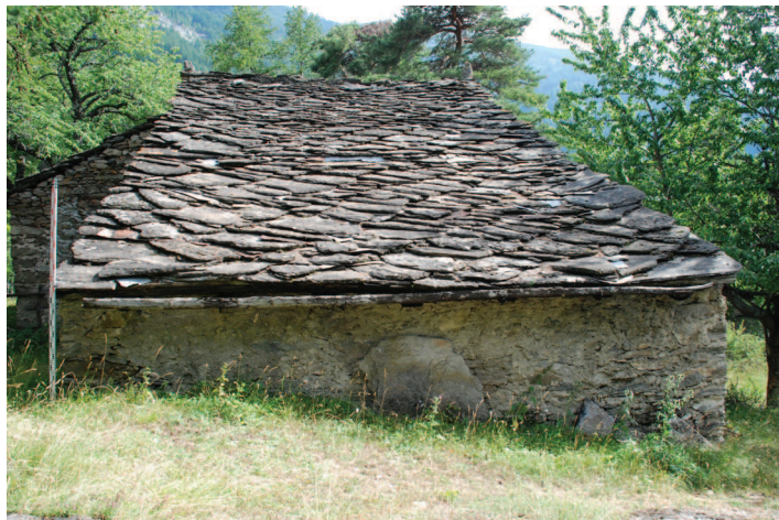
Dettaglio del manto di copertura in lose, con inserimento distribuito di fogli in lamiera nel tentativo di migliorarne la tenuta all'acqua.
